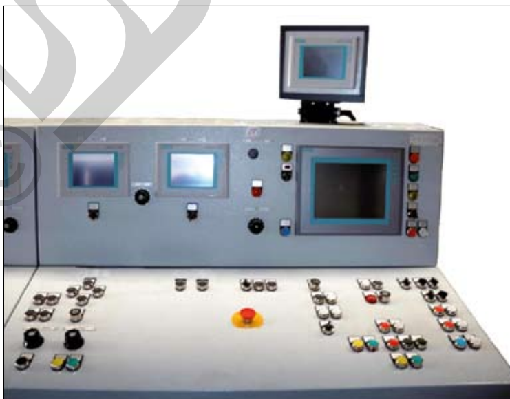
Steuerpult der Walzanlage
